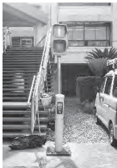
写真-2 実験時の機器設置状況
