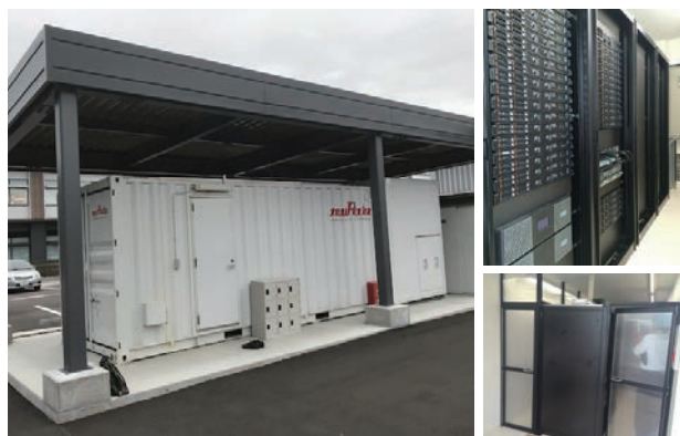
※写真は(株)村田製作所 長岡事業所に設置の直流給電サーバ 評価試験設備です。
